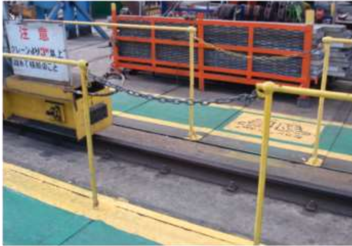
クレーン走行域への進入防止柵
